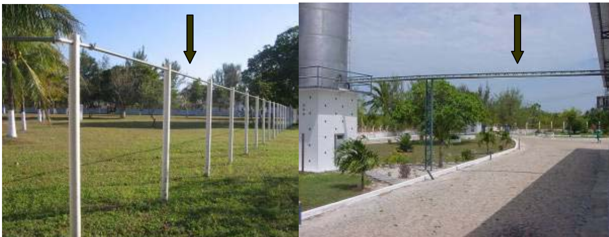
Foto 29 - Tubulação aérea em inox – Mineradora Límpida Fonte: Autora, 2007
