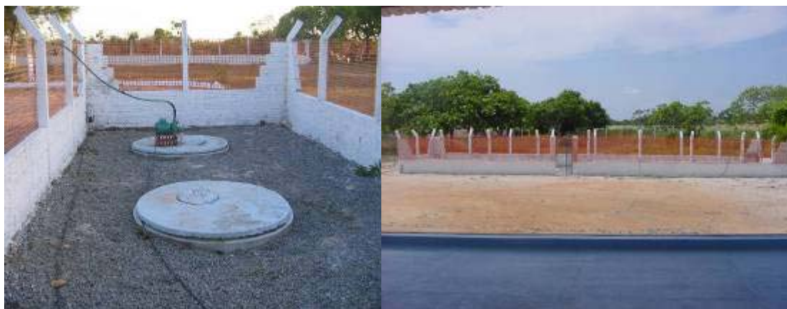
Foto 32 – Estação de tratamento da água da lavagem dos vasilhames – Mineradora Límpida Fonte: Autora, 2007
