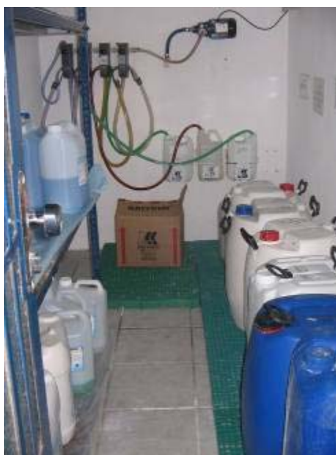
Foto 30 – Sala de produtos químicos – Mineradora Límpida Fonte: Autora, 2007
