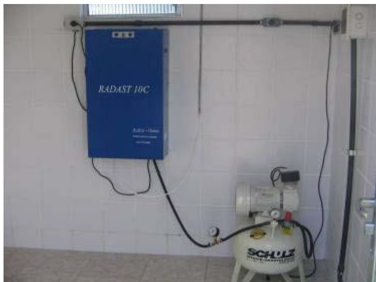
Foto 26 – Ozônio – Parte interna da casa de captação – Mineradora Límpida Fonte: Autora, 2007
