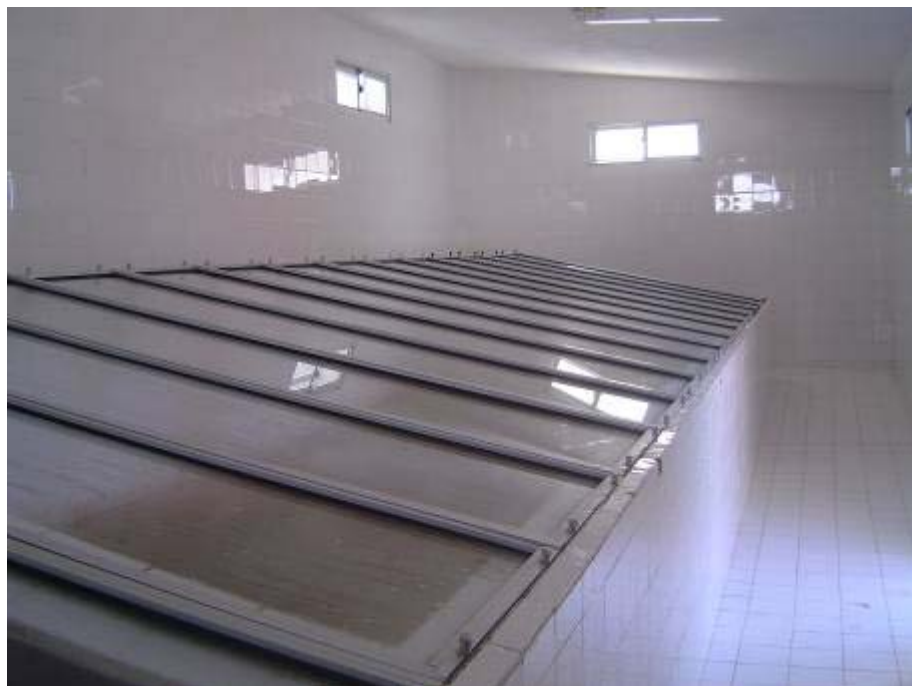
Foto 23 – Casa de captação de fonte de surgência - Ceará Fonte: DNPM, 2007
