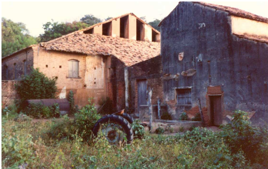
Foto 15 – Face norte do Tupinambá , no início dos anos 1990, pouco tempo antes do desabamento do telhado. Observa-se, vistas de fora, as aberturas entre pilares, criadas a partir dos desníveis das águas da coberta. Fotografia Yacê Carleial.
