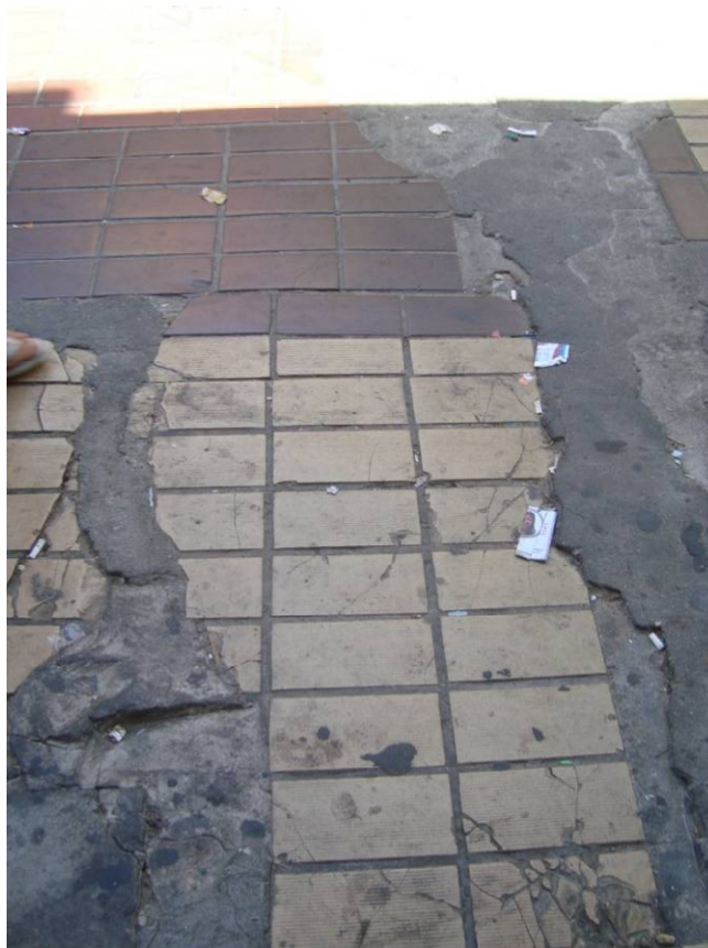
Figura IV-3.56: Péssimo estado de conservação da pavimentação em trechos do calçadão (Rua Liberato Barroso).
