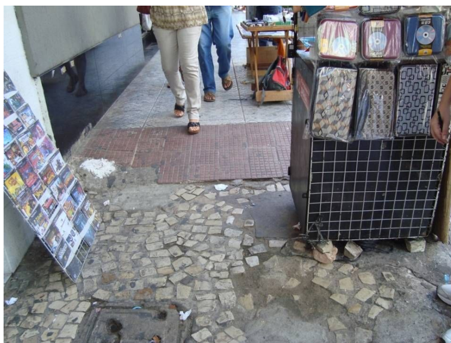
Figura IV-3.66: Pavimentação irregular da calçada (Rua Barão do Rio Branco)
