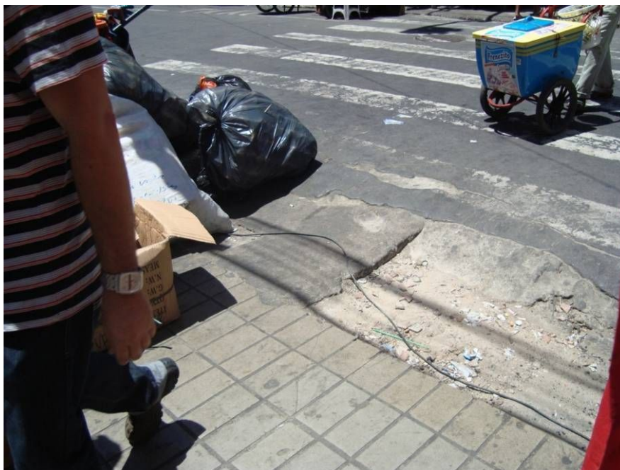
Figura IV-3.61: Pavimentação irregular no acesso ao calçadão (Rua Guilherme Rocha)
