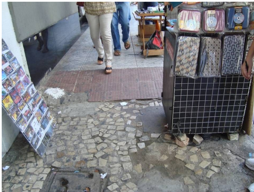
Figura IV-3.66: Pavimentação irregular da calçada (Rua Barão do Rio Branco)
