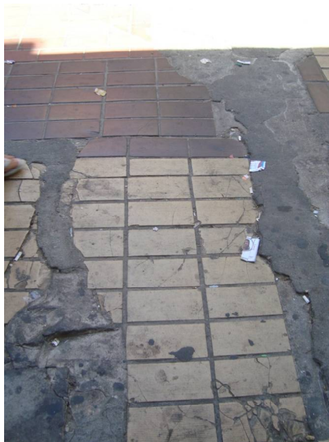
Figura IV-3.56: Péssimo estado de conservação da pavimentação em trechos do calçadão (Rua Liberato Barroso).
