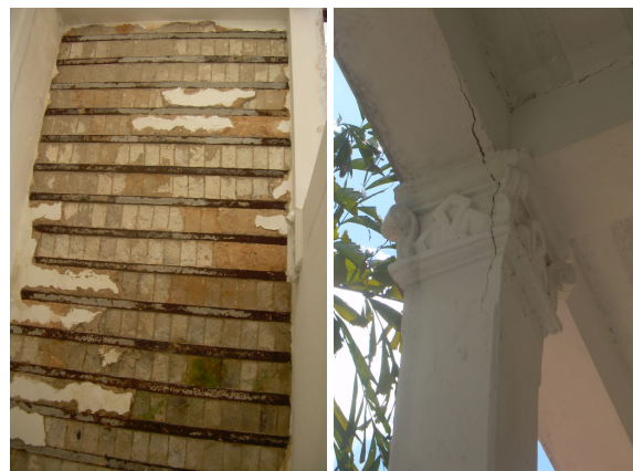
Vista estrutura mal conservada
