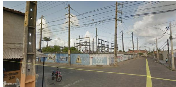
Figura 5.31. Localização 20: Subestação da Companhia Energética do Ceará (COELCE). 1
