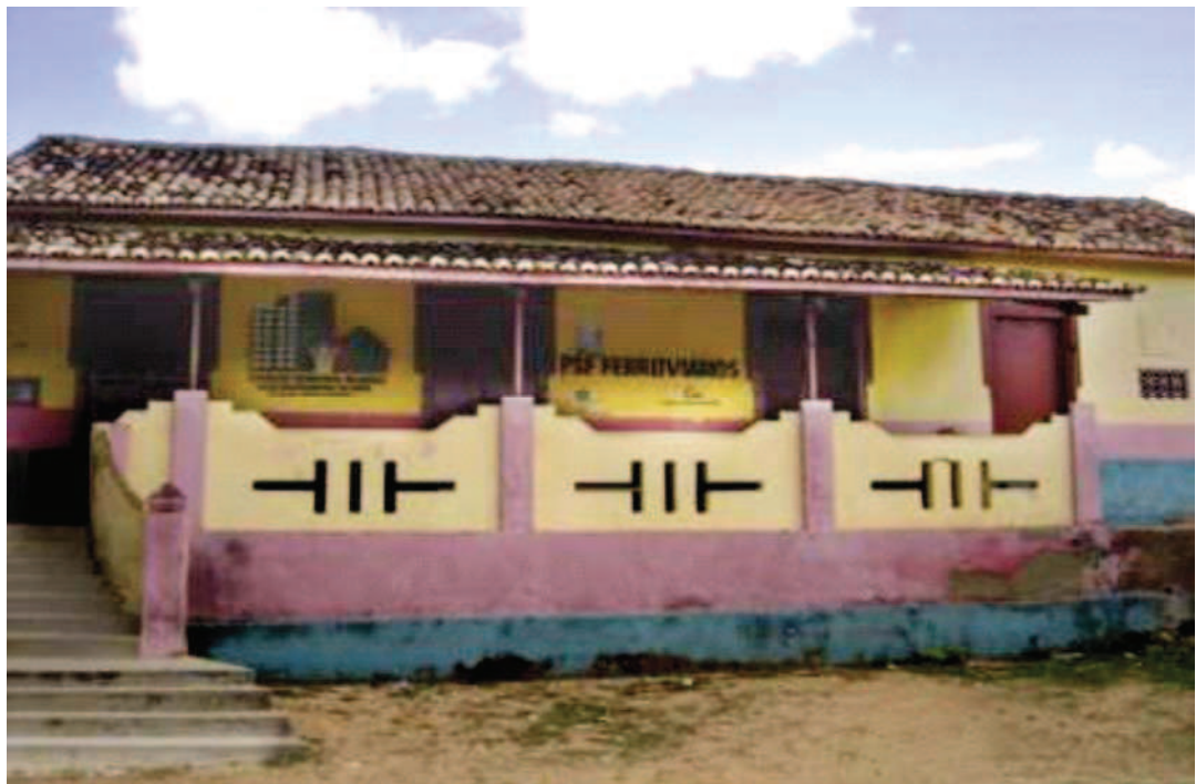
Figura 5 – Na antiga residência do gerente de depósito da RVC/RFFSA, em Cedro (CE), funciona nos dias atuais o PSF Ferroviários. Foto do autor (26/12/2008)/Acervo do autor.
