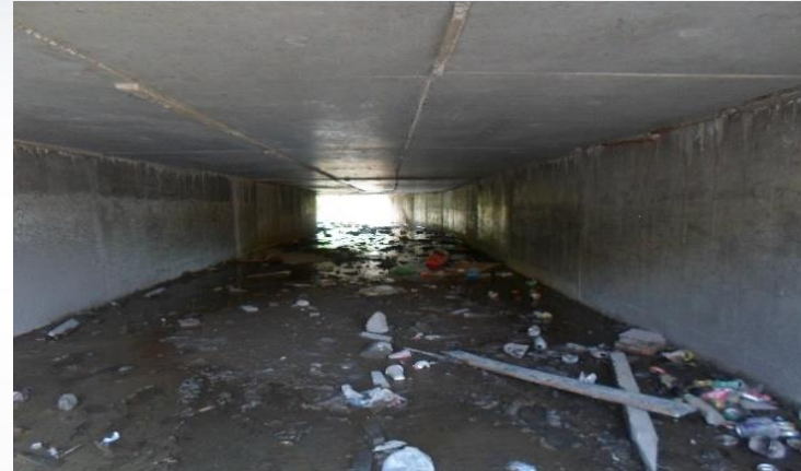
Obstruções das redes por lixo
