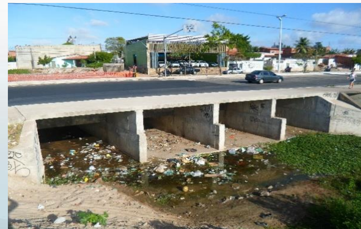
Obstruções das redes por lixo
