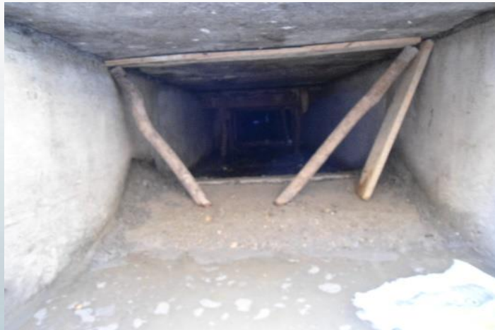
Interferência de redes externas nas galerias de drenagem
