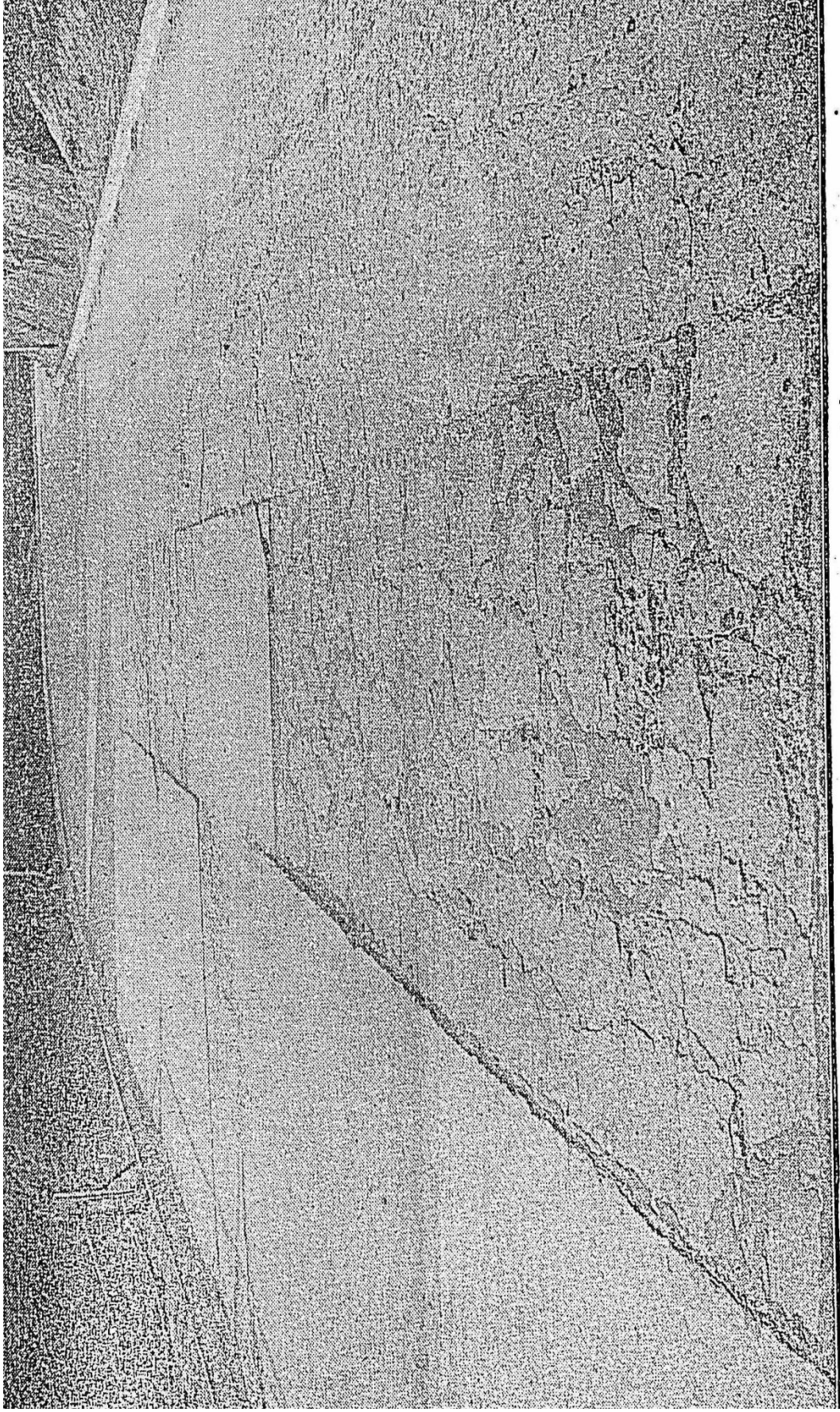
ESTRADA RIO-PETROPOLIS — Trecho onde se nota esmagamento mais pronunciado na faixa central.
