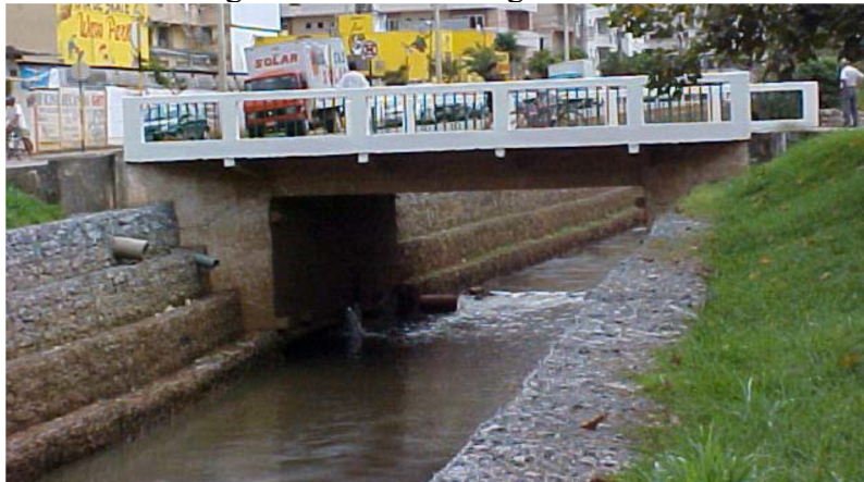
Figura 34 – Canal em gabião caixa
