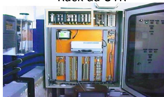
Rack da UTR
