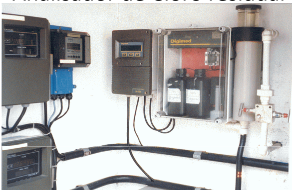
Analizador de Cloro residual
