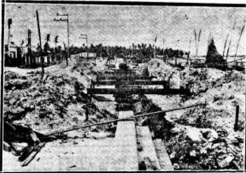
O ritmo febricitante das obras da Beira Mar possibilitaram a construção de quase mil metros até agora. Todavia os mais diferentes obstáculos se opõem ao aceleramento
