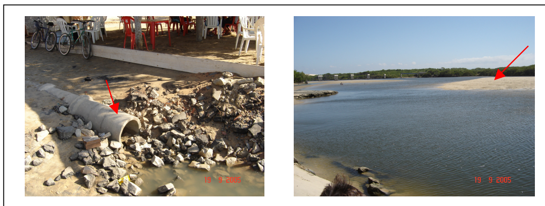
Figura 12. Lançamento de esgotos e assoreamento do rio Cocó.
