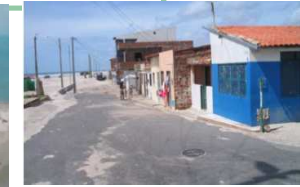
Parte do trecho associado com invasão das areis na via de acesso e residências, 2005. Fonte: Projeto Orla
