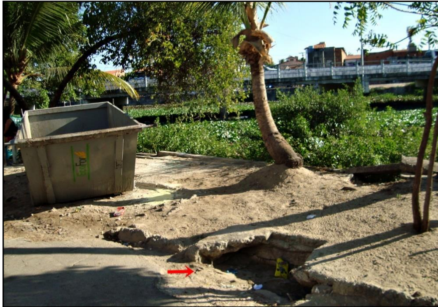
Figura 34 – Sistema de drenagem pluvial parcialmente atulhado de sedimentos e resíduos sólidos na margem esquerda do riacho Tauape
