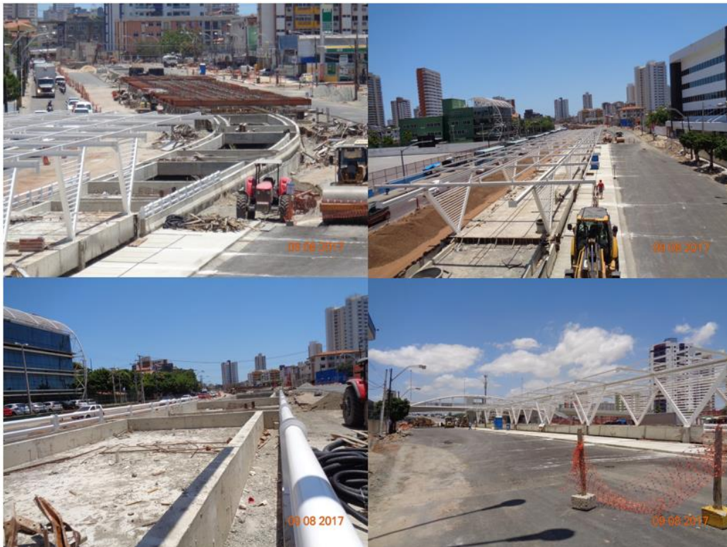
Figura 26 – Execução da obra para implantação do sistema BRT na Avenida Aguanambi Fonte: acervo pessoal
