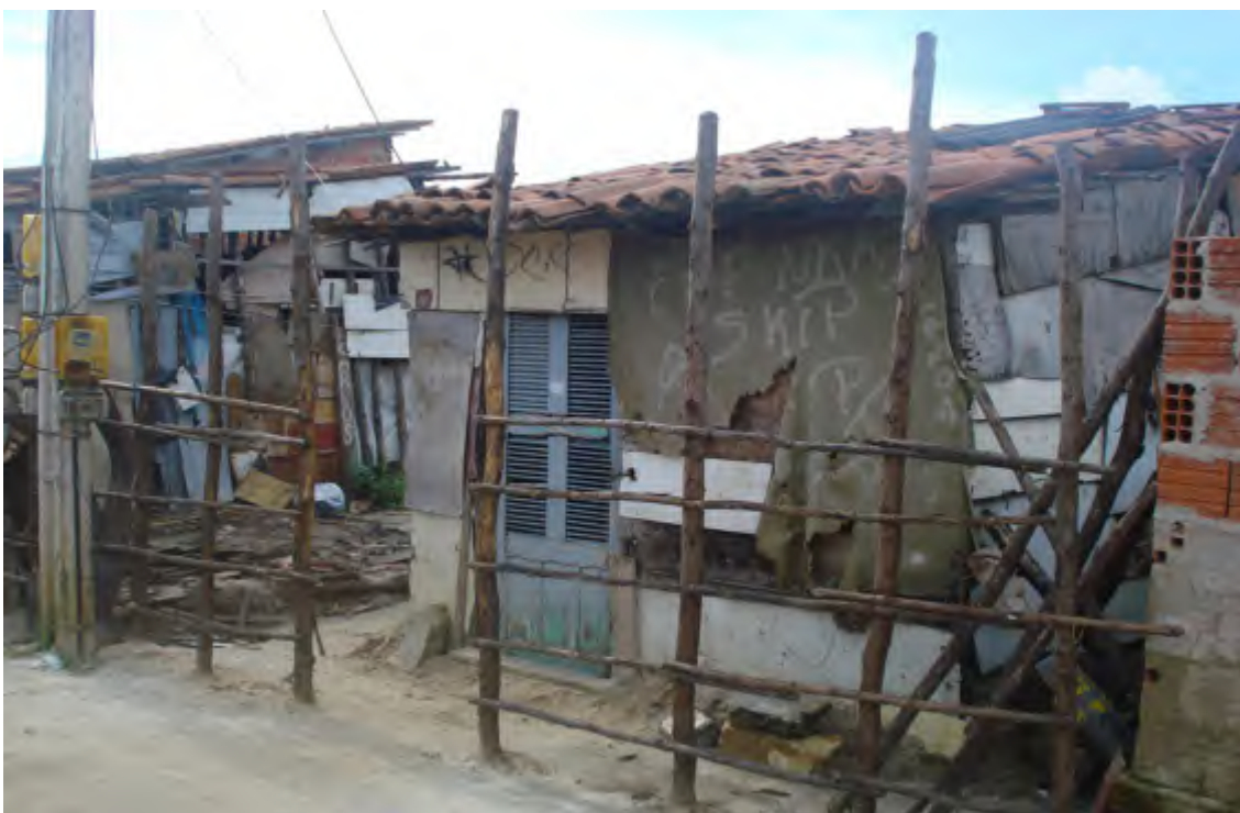
FOTO 30 – Aspecto de uma moradia da comunidade do mangue do bairro Vila Velha. Notar as precárias condições da moradia em questão. Fotografia realizada pelo autor em 21 de Maio de 2008.
