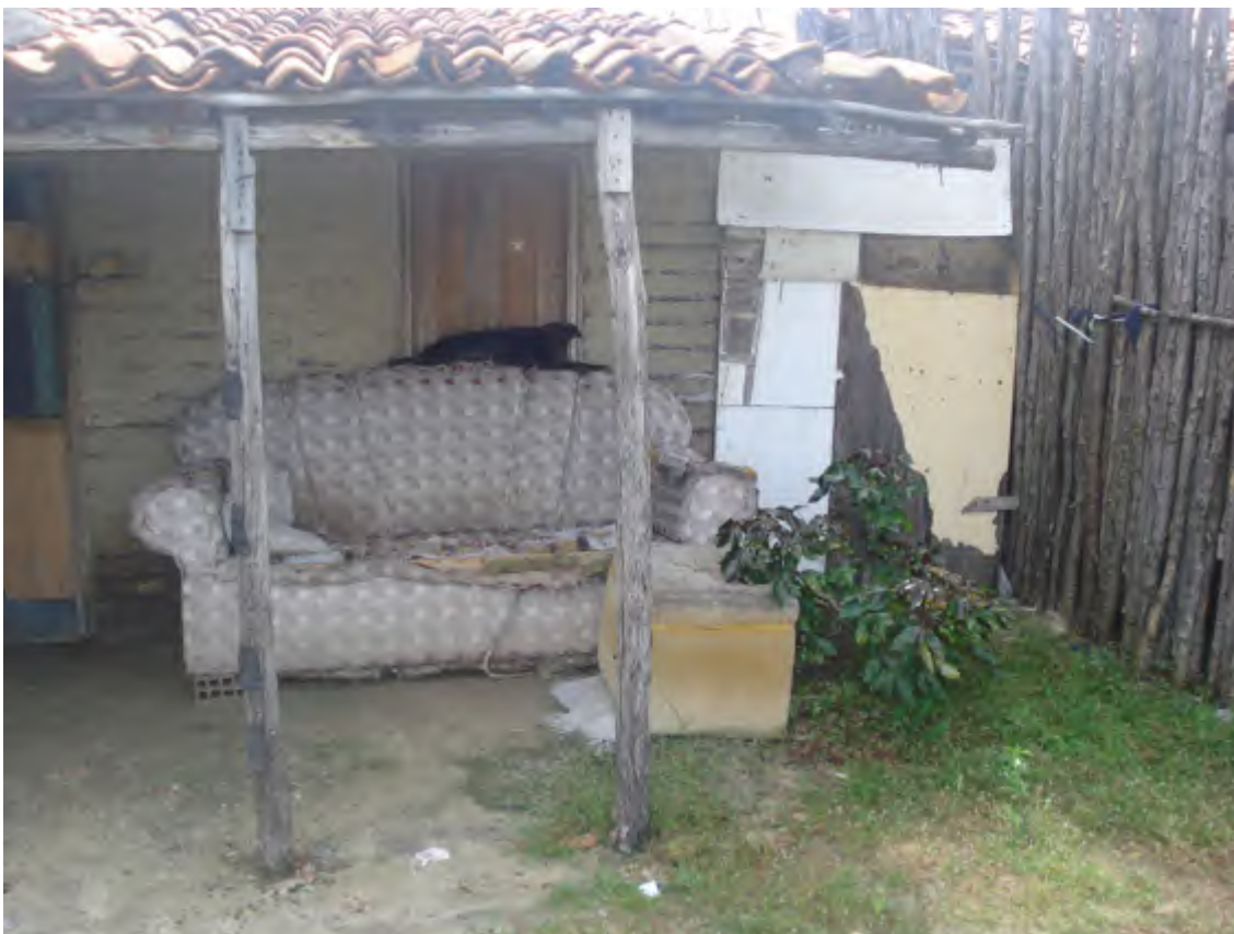
FOTO 19 – Aspecto de uma moradia da comunidade do mangue do bairro Vila Velha. Notar a precária condição da moradia em questão. Fotografia realizada pelo autor em 23 de Maio de 2008.
