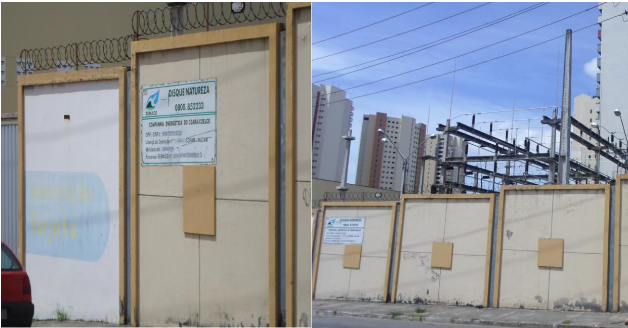
Figura 3.13 – Subestação de Distribuição Varjota.
