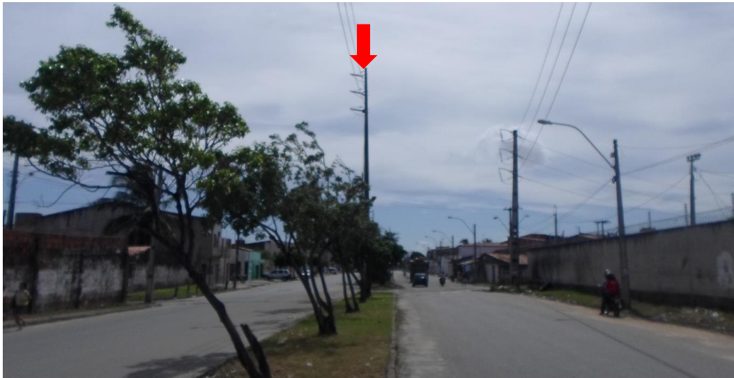
Figura 3.14 – Primeiro poste após Subestação Delmiro Gouveia (CHESF).
