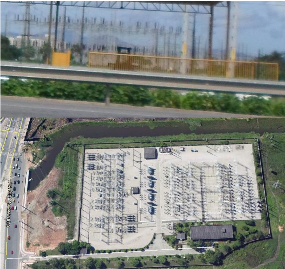
Figura 3.12 – Subestação Delmiro Gouveia (CHESF).
