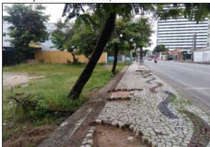
Figura 3. Exemplo de pavimentação imprópria e sem manutenção na Av. João Pessoa, bairro Damas
