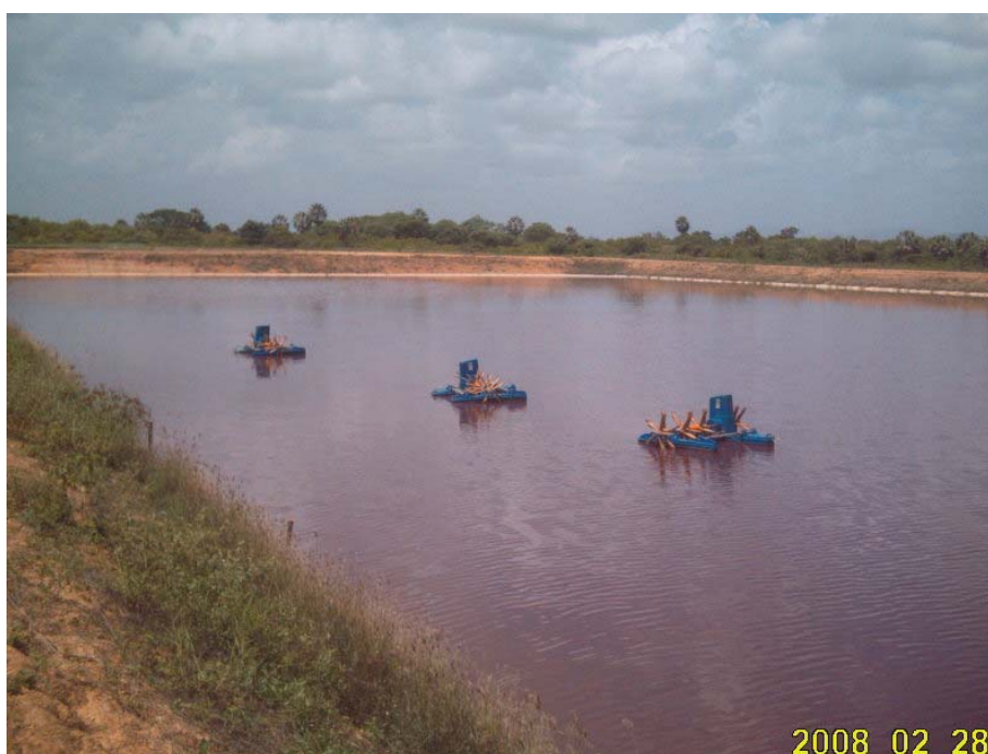
AERADORES PARADOS NA LAGOA FACULTATIVA
