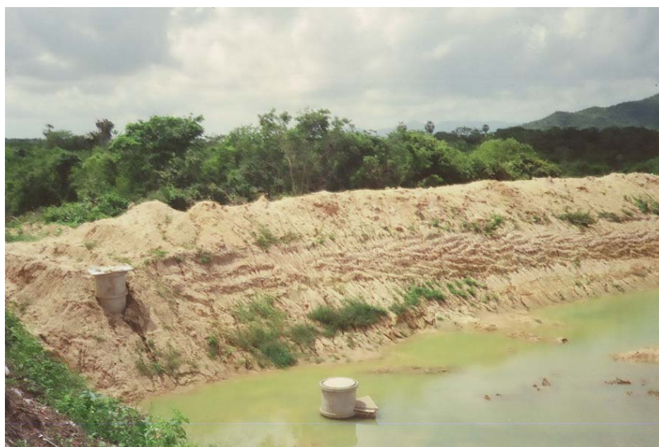
CAIXA COLETORA DE CHORUME E POÇO DE VISITA
