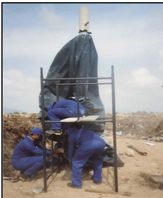
Encamisamento de dreno vertical para medição de temperatura, velocidade e percentual de gases no interior no dreno
