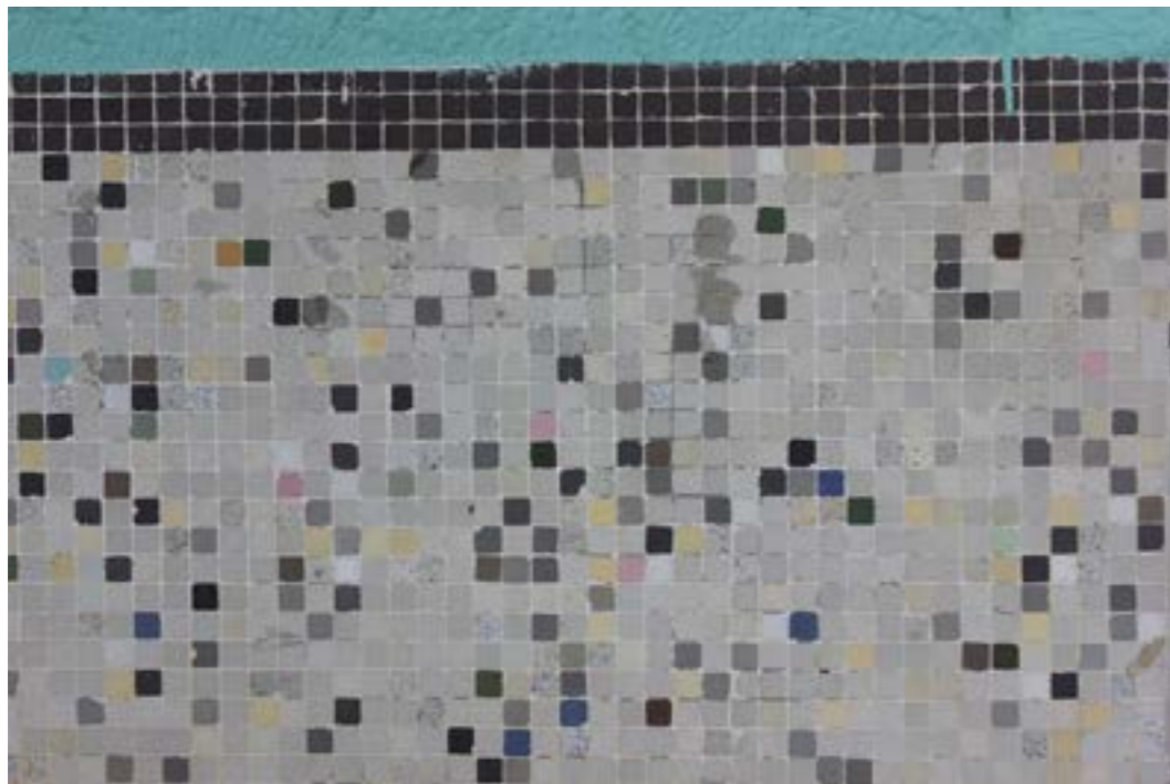
Figura 10 - Pastilhas vitrificadas na base do prédio principal.
