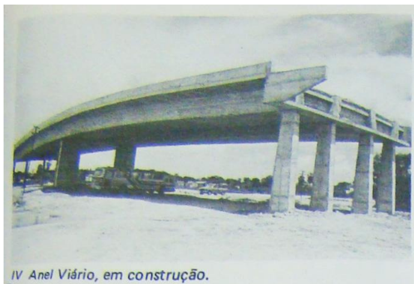
Figura 3 - Foto da obra do IV anel viário que interligava as principais rodovias que davam acesso à Fortaleza. 194
