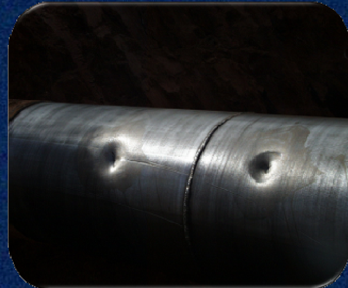
Duto atingido por escavadeira
