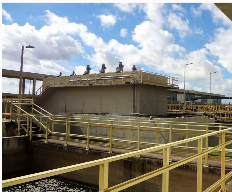
Estação de Tratamento ETA Gavião/ Fonte: Cagece, 2013
