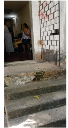
4 DEGRAU EM DESCONFORMIDADE COM A NORMA NBR 9050 FONTE: IPLANFOR
