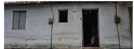
2 INFILTRAÇÃO NAS FACHADAS FONTE: IPLANFOR
