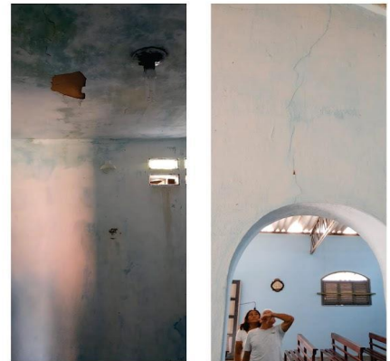
1 INFILTRAÇÃO NA CAPELA FONTE: IPLANFOR
