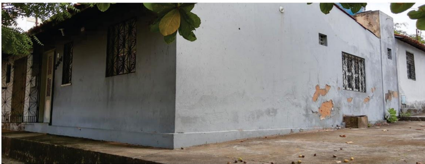
3 INFILTRAÇÃO NA FACHADA/REBOCO DESCASCANDO FONTE: IPLANFOR
