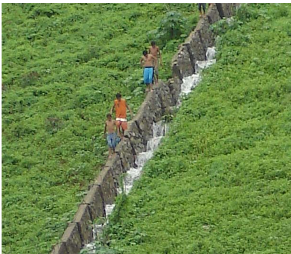
Figura 46: Drenagem pluvial na área do aterro do Jangurussu. Notar a velocidade do escoamento.
