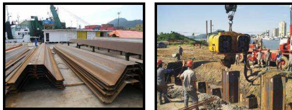
Figura 131. Estacas-prancha metálicas utilizadas em obras portuárias no Estado de Santa Catarina. Fotos: CARUSO JR. (2005 e 2008).
