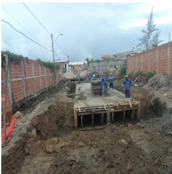
Figura 3.8.1.3 – Galeria celular de concreto armado, seção 2(220x100) cm, executada entre as estacas 4 e 5+2,00m da Rua Umarizeira.
