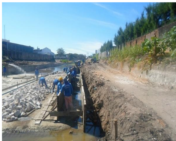
Figura 2.2.1.4 – Execução da parede do canal em alvenaria de pedra, entre as estacas 35+10,00m e 36+10,00m
