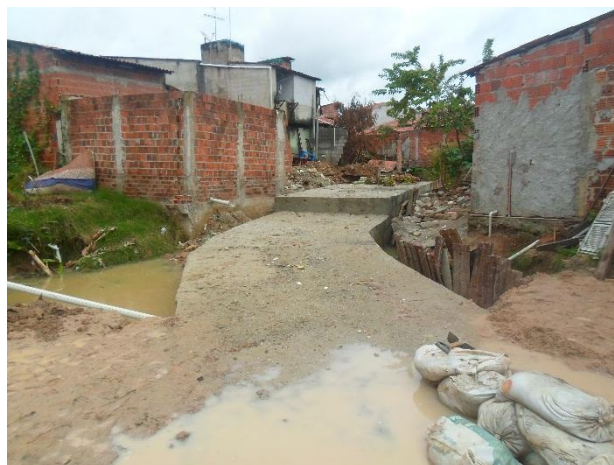
Figura 3.5.1.4 – Galeria de seção (300x120) cm concluída no trecho entre as estacas 6 e 7+5,00m.
