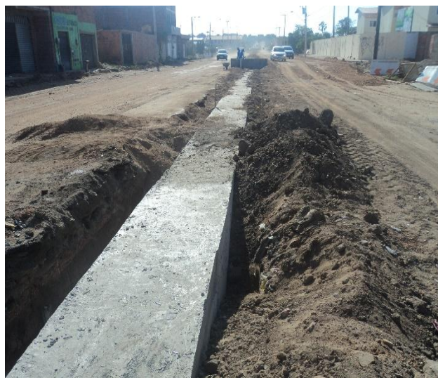
Figura 3.7.1.6 – Galeria (70X70) cm finalizada, entre estacas 35+10,00m e 48, na Avenida Luiz Montenegro.
