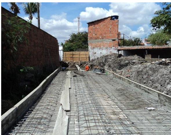
Figura 2.4.1.5 – Galeria de seção 2(170 x 100) cm –Laje superior armada entre as estacas 26+15 e 28.
