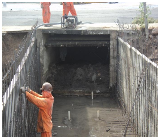
Figura 2.3.1.6 – Interferências de redes de água e de telefonia encontradas no bueiro da Av. Rogaciano Leite na junção com a galeria da Av. Walter Bezerra de Sá.
