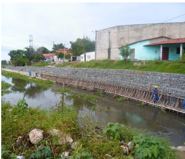
Figura 2.5.1.9 – Execução do revestimento dos gabiões tipo caixa entre as estacas 2 e 5 na margem esquerda.
