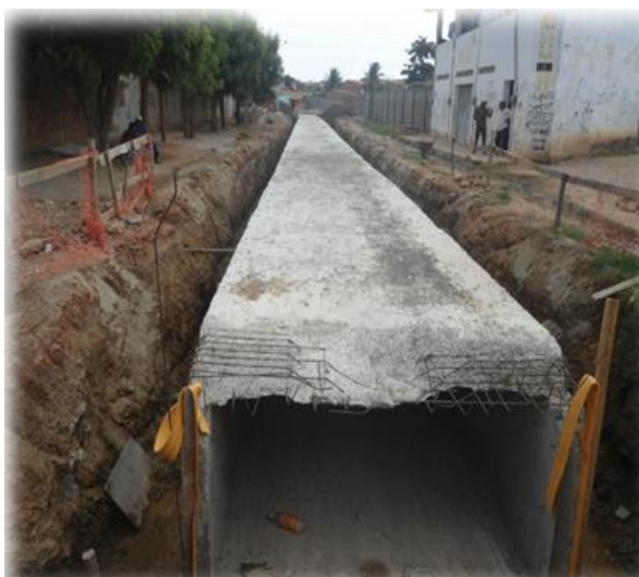
Figura 3.4.1.5 - Galeria de drenagem na av. Sapiroanga
