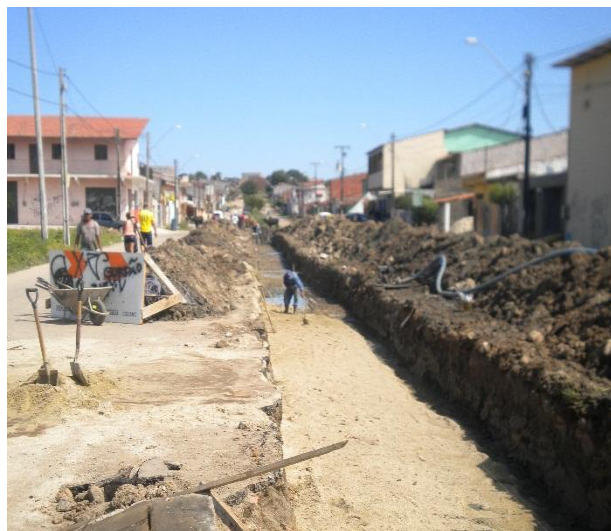
Figura 3.7.1.2 – Trecho escavado para execução da galeria celular (150x80) cm na Avenida Luiz Montenegro, estaca 21 a 25.
