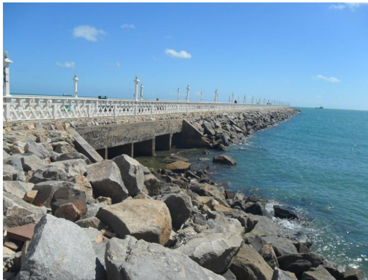
Figura 15: Controle da erosão na Ponte dos Ingleses
