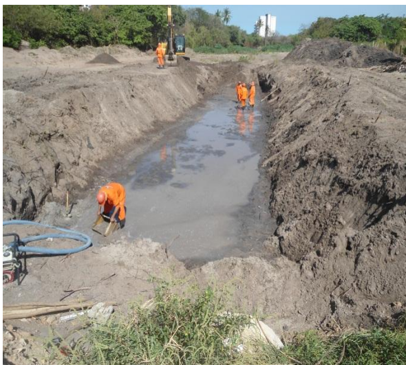
Figura 2.3.1.1 – Início da escavação para execução da galeria celular de seção (250 x 140) cm entre estacas 9 e 10+5 na Av. Walter Bezerra de Sá.
