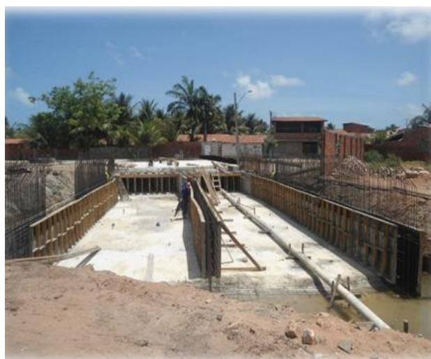
Figura 3.4.1.4 - Galeria dupla na interseção do canal com a galeria de drenagem na av. Sapiroanga
