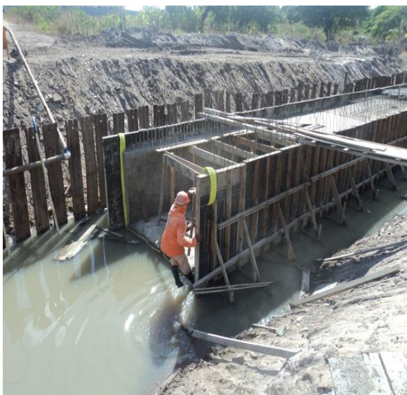
Figura 2.3.1.3 – Paredes executadas da galeria celular de seção (250 x 140) cm entre as estacas 9 e 11+5 na Av. Walter Bezerra de Sá.
