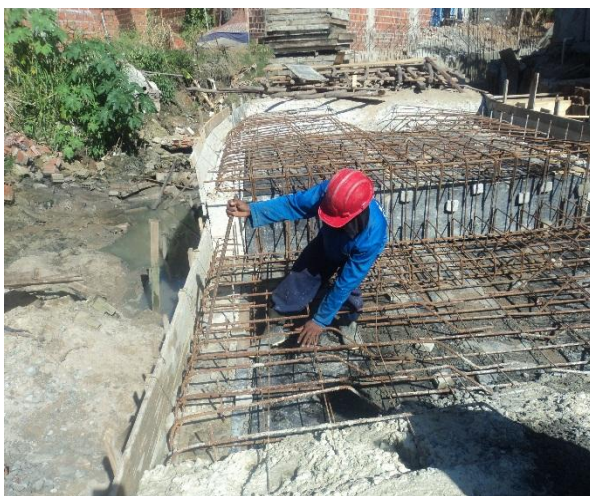
Figura 3.5.1.3 – Execução de degrau da laje superior da galeria de seção (300x120) cm no trecho entre as estacas 6+10,00m e 7.
