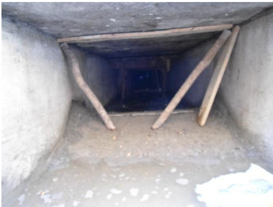
Figura 7: Interferência de redes externas nas galerias de drenagem
