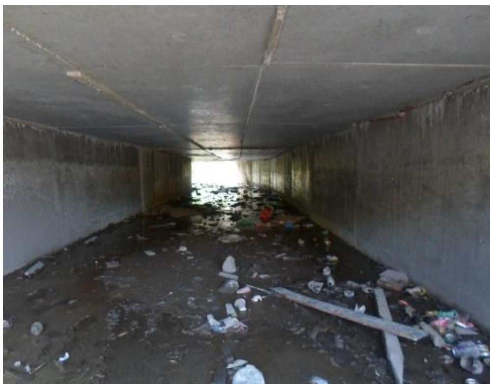
Figura 8: Obstruções das redes por resíduos sólidos
