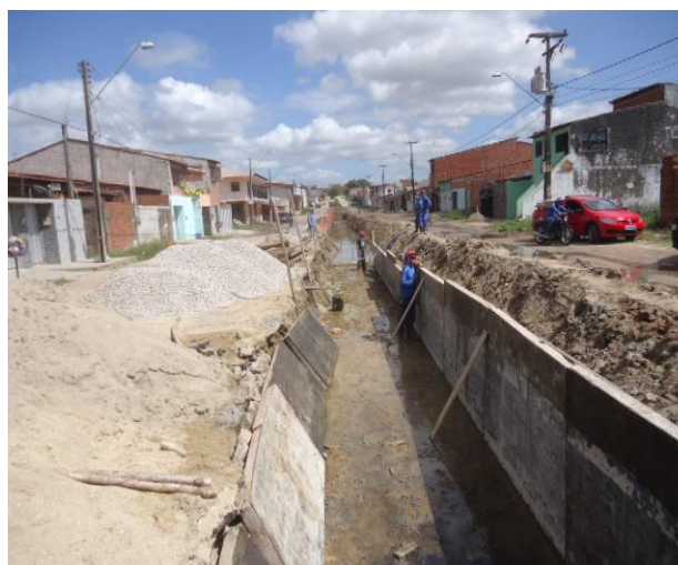
Figura 3.7.1.4 – Montagem das formas para execução de galeria (150x80) cm na Avenida Luiz Montenegro, estaca 22 a 23.
