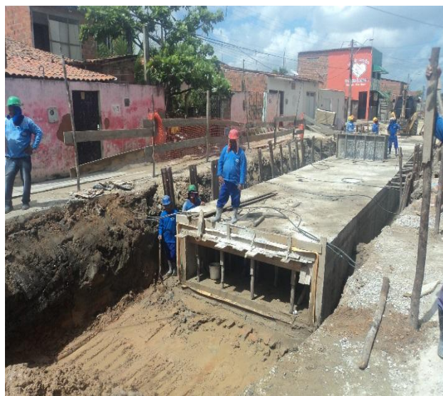
Fig. 3.8.1.8 – Galeria celular em concreto armado executada, seção (300 x 100) cm, entre estacas 5+2,00m e 6+10,00m.
