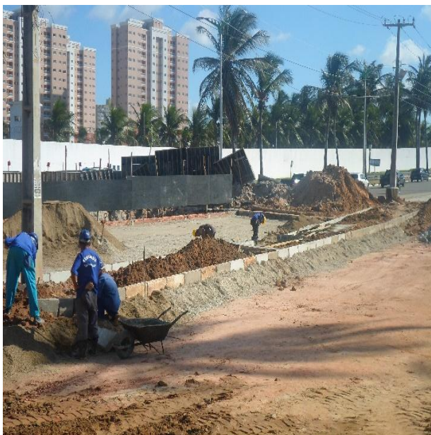
Figura 2.1.1.1 – Execução da sub-base com duas camadas de 20 cm de piçarra, entre as estacas 22 e 20+15,00m;
