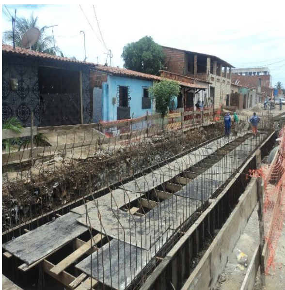
Figura 3.8.1.5 – Formas e armaduras posicionadas das paredes da galeria celular de concreto armado, seção (300 x 100) cm, entre as estacas 2 e 3 da Rua São Basílio.
