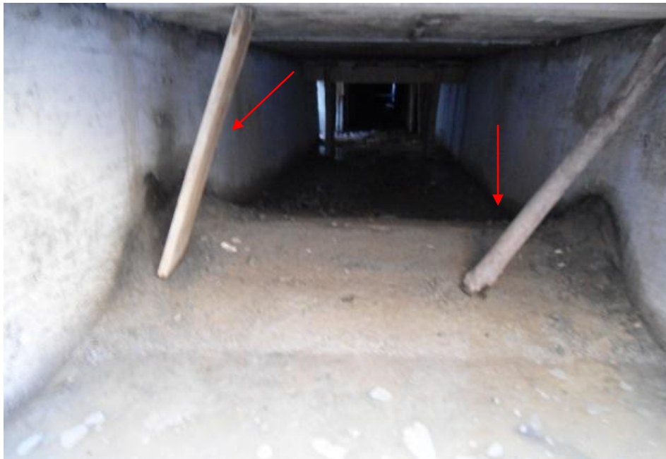
Figura 6: Interferência de redes externas nas galerias de drenagem
