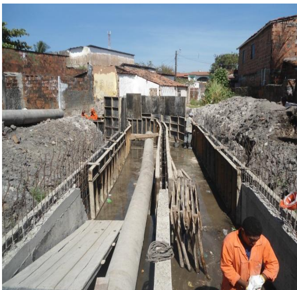
Figura 2.4.1.1 – Galeria de seção 2(170 x 100) cm – Execução das formas entre as estacas 31 e 30.
