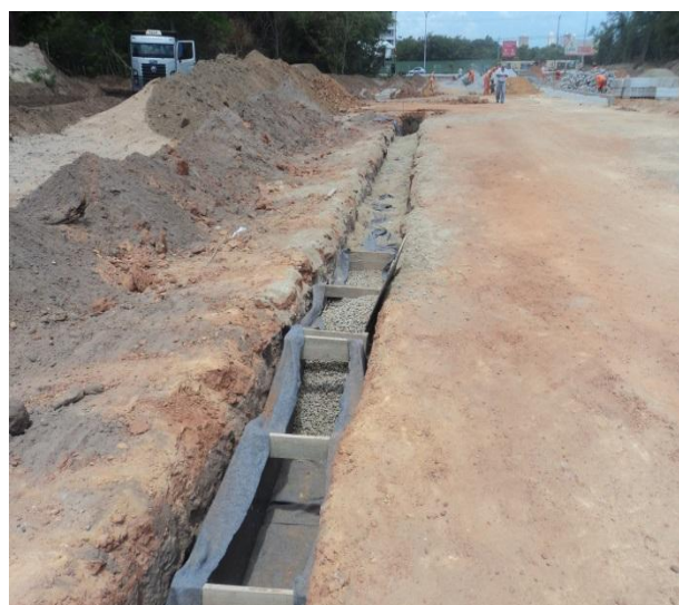
Figura 2.3.1.4 – Início da execução das trincheiras drenantes na Av. Walter Bezerra de Sá entre as estacas 1 e 2.
