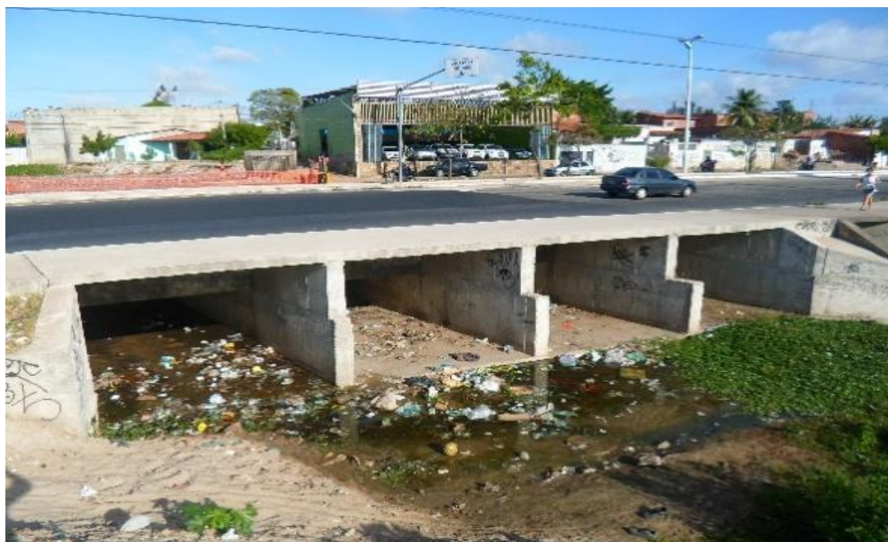
Figura 9: Obstruções das redes por resíduos sólidos
