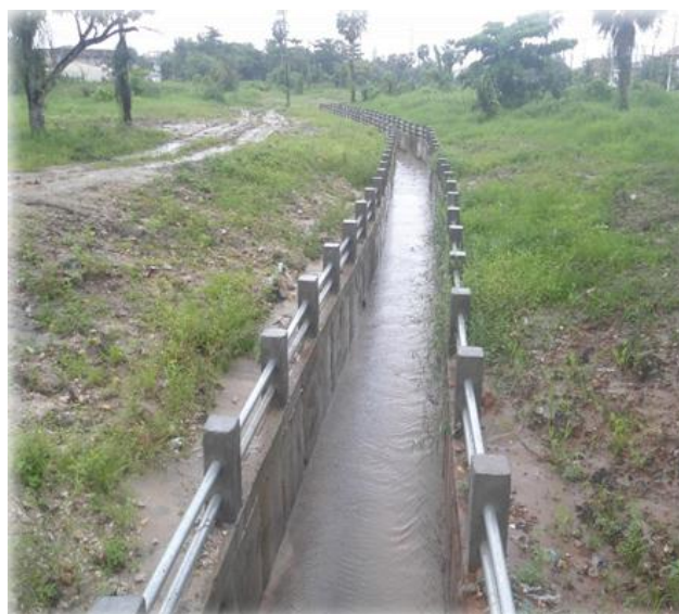
Figura 3.6.1.8 – Trecho completo do canal
