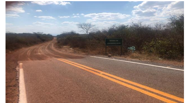
CE-323 entre Carnaubal e Guaraciaba do Norte. Após a placa de divisa dos Estados a estrada na parte do Piauí está sem asfalto.
