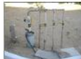
P201 - Poço tubular do Igreja Nossa Senhora do Lourdes - Papico, Agosto/2010 (UTM: 958945/550483)
