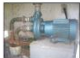
P218 - Poço tubular do RNB - Passará, Agosto/2010 (UTM: 9576342/553179)
