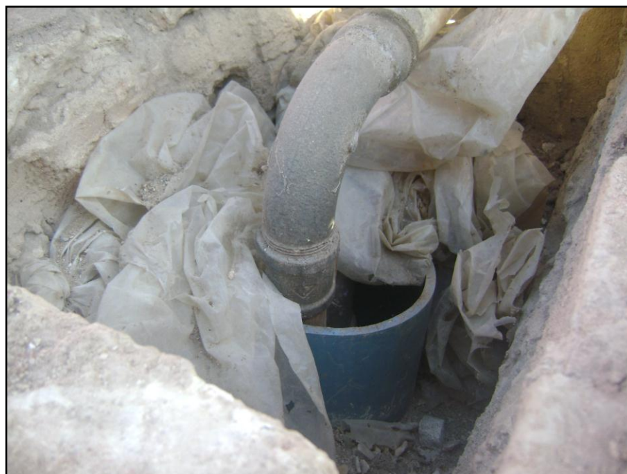
Figura 6.5.2 - Poço tubular profundo (P208) utilizado como chafariz público no bairro da Lagoa Redonda, Fortaleza - CE (Agosto/2010). Coord.: (UTM: 9577759/560476)
