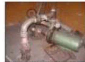
P121 - Poço tubular da praça da baía São Gerardo, Agosto/2010 (UTM: 9588061/545541)
