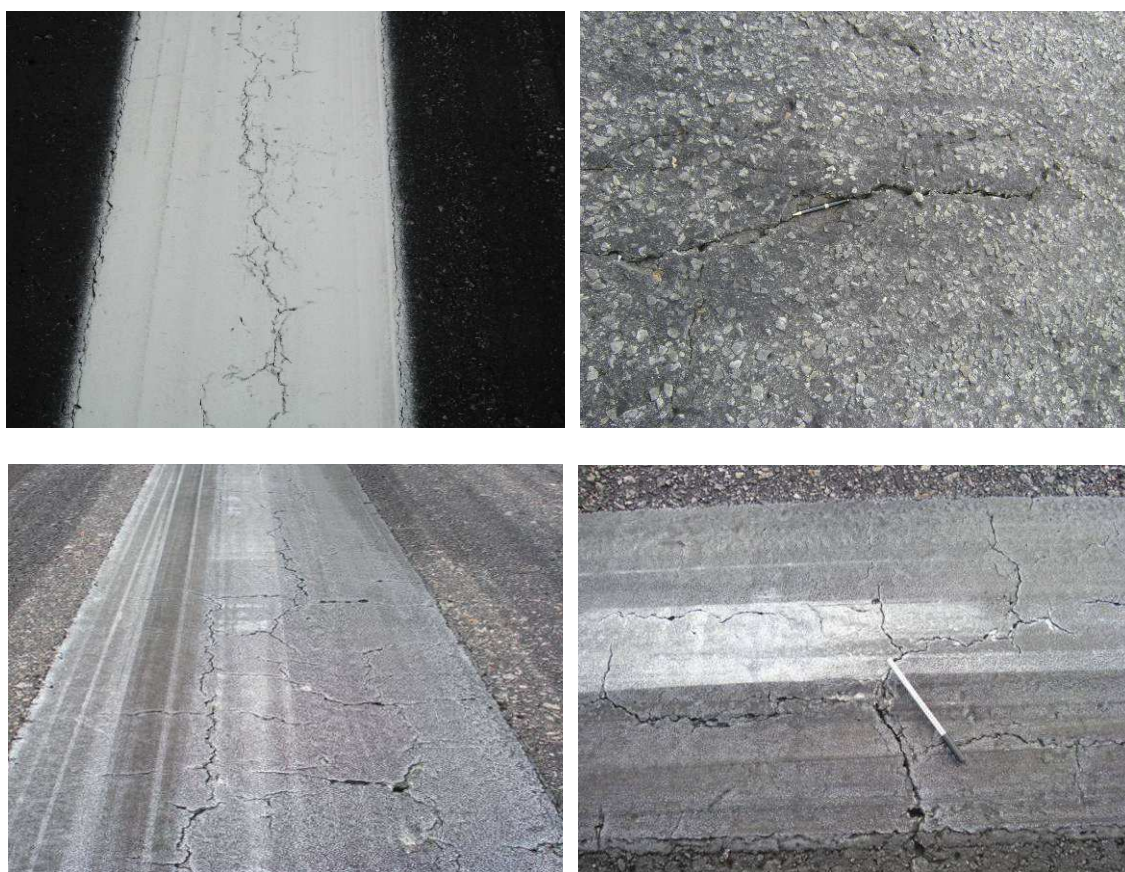
Figura 5.19 – Trincas longitudinais e transversais.
