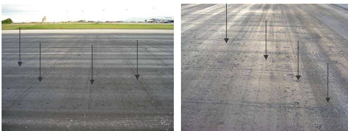
Figura 5.31 – Danos provocados na pista de pousos e de decolagens pelos equipamentos de remoção de borracha.
