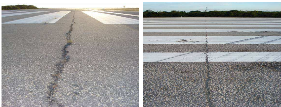
Figura 5.21 – Trincas de reflexão nas cabeceiras da pista
