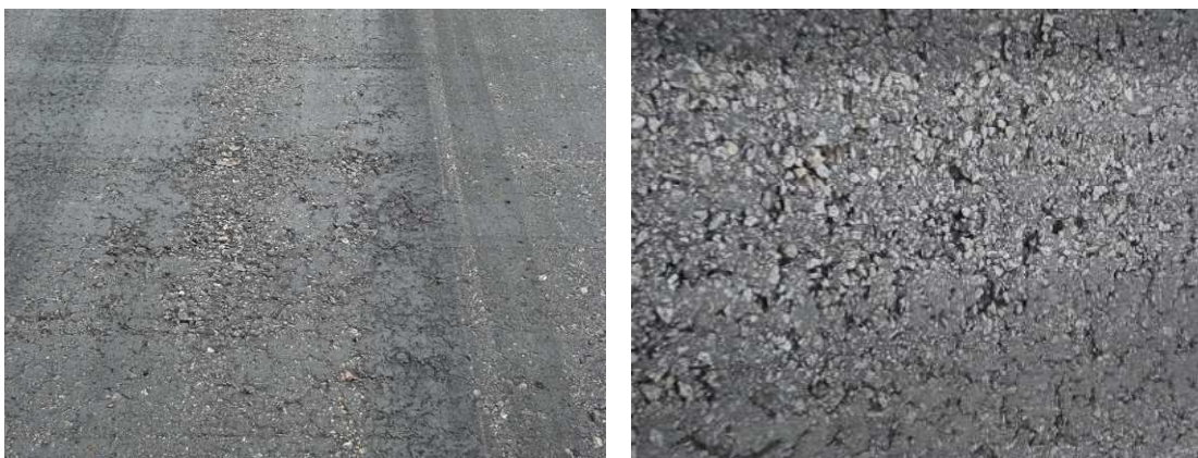
Figura 5.30 – Deterioração da superfície da pista de pousos e de decolagens ocasionada pelos serviços de remoção de borracha.
