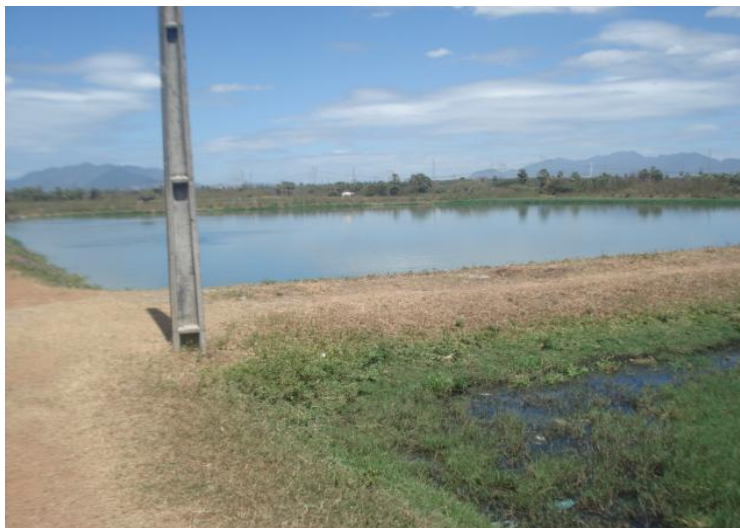
Imagem 3 – Lagoa de estabilização do Conjunto Palmeiras em funcionamento, ao lado a segunda lagoa assoreada
