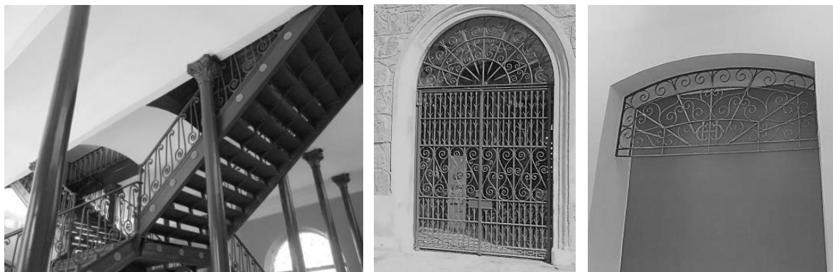
Figura 73 – Colunas em ferro fundido e Gradis (portão e bandeira)
