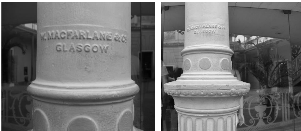
Figura 124 – Coluna da estrutura do Teatro com a marca do fabricante gravada em relevo
