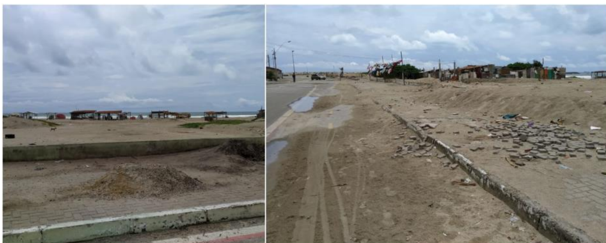
Figura 05: Acúmulo de sedimentos no calçadão (imagem à esquerda) e avanço de sedimentos sobre calçadão e ciclovia.
