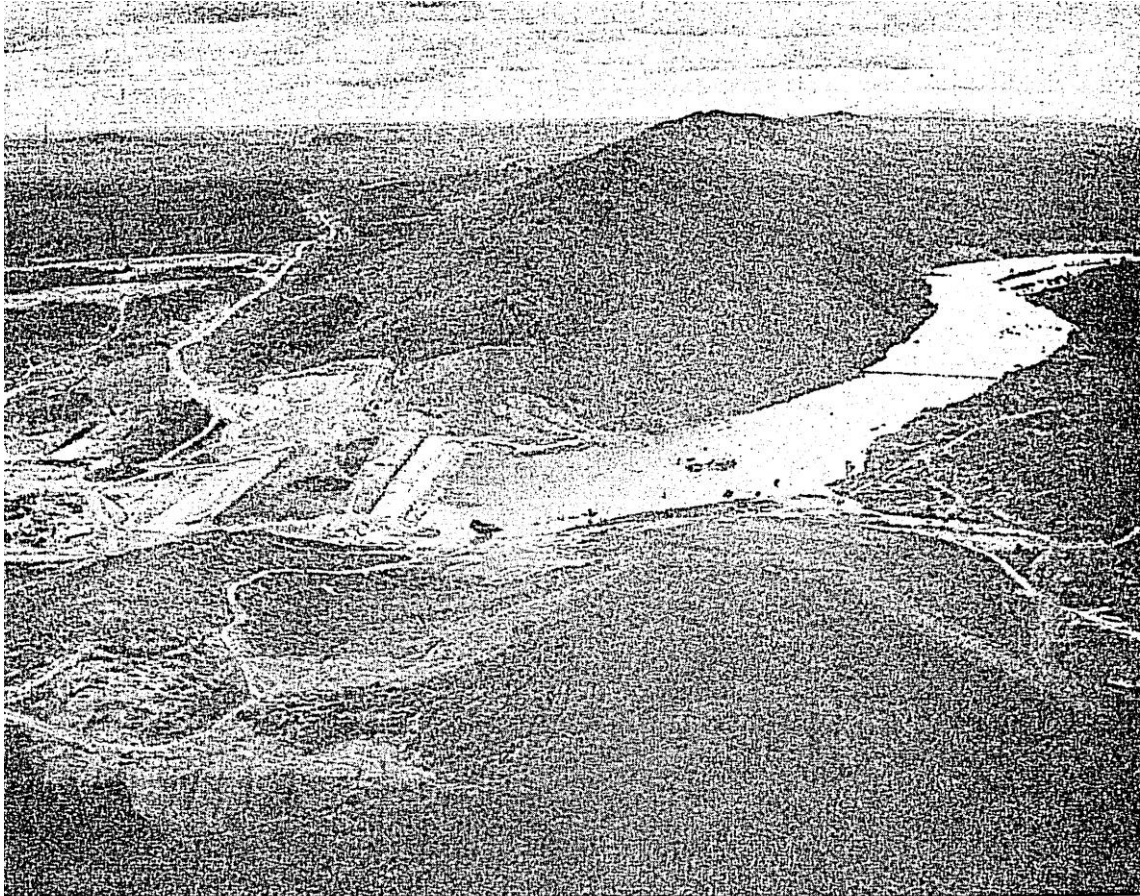
Barragem de terra de maior volume em construção no Polígono das Sêcas. Formará o Açude Banabuiú, no Município de Quixadá, Sistema do Jaguaribe, Estado do Ceará. Vista em 1959.
