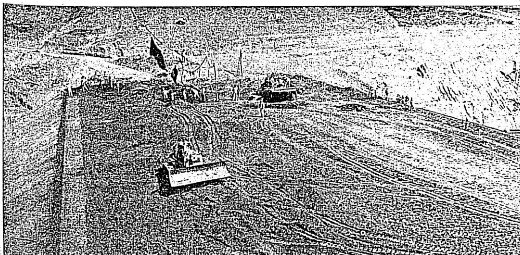
Trabalhos de construção do maciço terroso do Açude Vertente do Heráclio, no Município de Surubim, Sistema Complementar, Estado de Pernambuco. Iniciado na seca de 1958.
