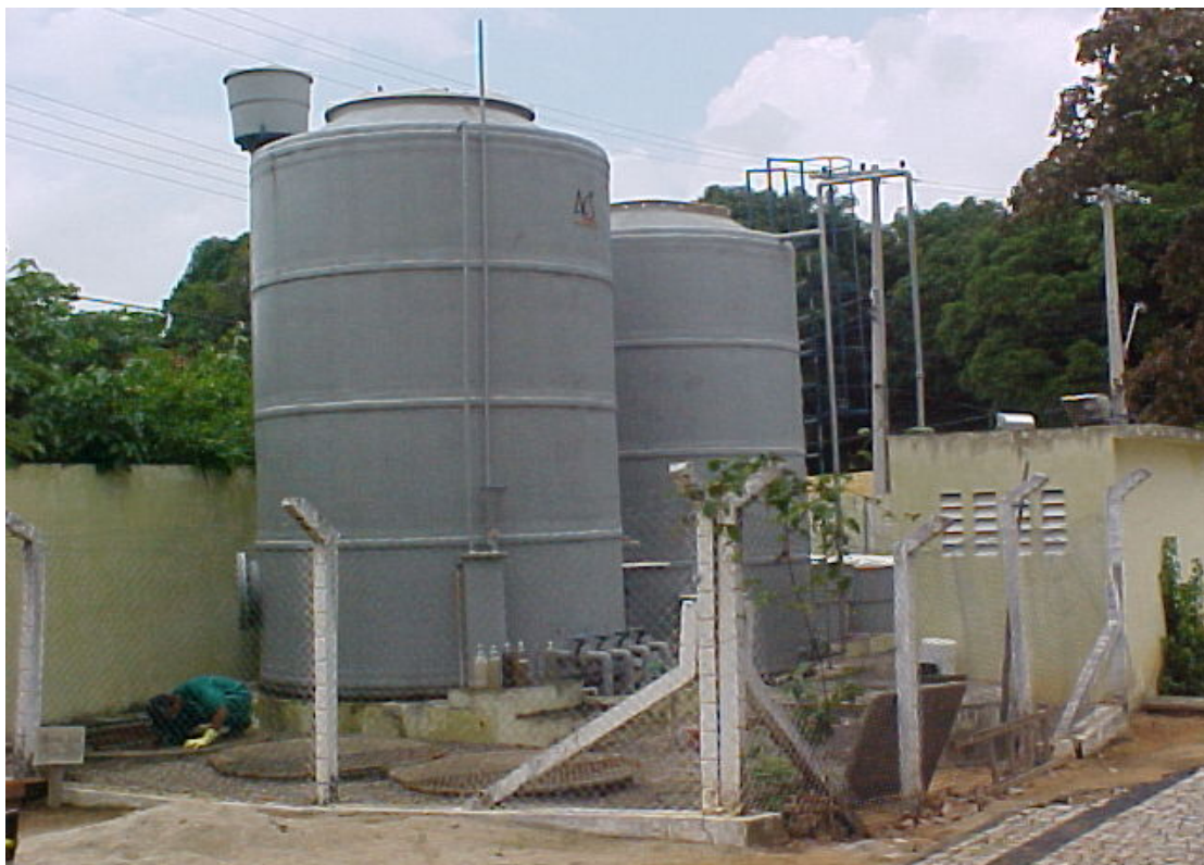
FIGURA 6.3 - Vista da ETE do HGWA
