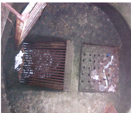
FIGURA 6.1 – Caixa de grade
