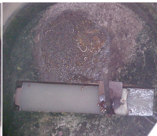
FIGURA 6.2 – Caixa de areia
