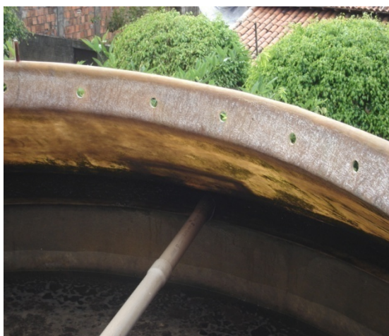
FIGURA 6.11 – Retorno de lodo do decantador
