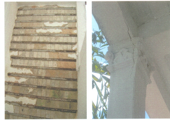
Vista estrutura mal conservada
