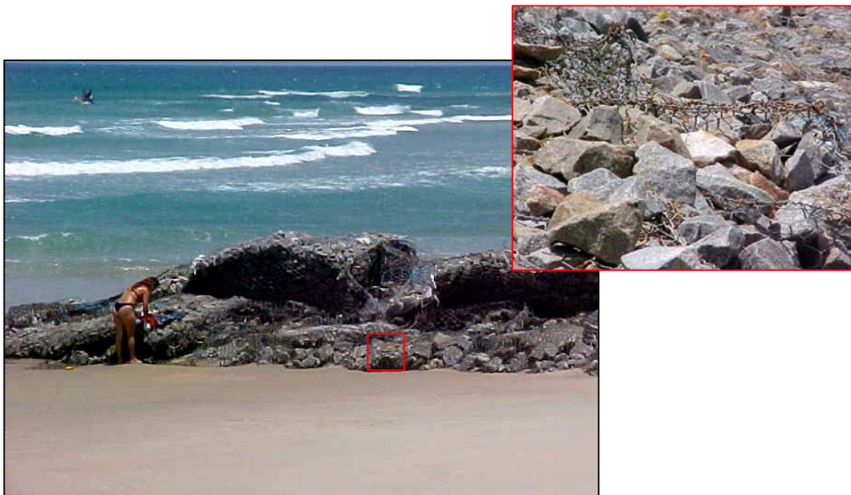
Figura 70. A ação erosiva das ondas e a falta de manutenção foram responsáveis pela perda da funcionalidade do espigão Nº 4 aumentando a erosão na célula 2.
