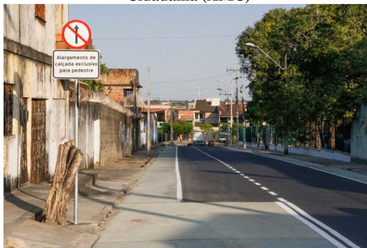
Figura 3 - Obra do Binário recém executado Secretaria Municipal de Conservação e Serviços Públicos (SCSP), por meio do Plano de Ações Imediatas de Transporte e Trânsito de Fortaleza (PAITT), em parceria com a Autarquia Municipal de Trânsito e Cidadania (AMC)
