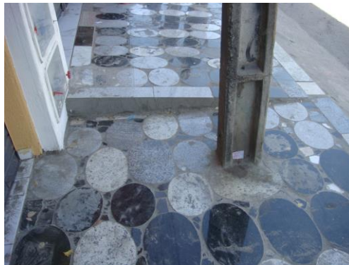
Figura 15 – Situação 01: Revestimento impróprio e calçada interrompida Fonte: registro da autora
