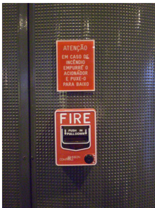
Figura 30: Acionadores do alarme de incêndio.
