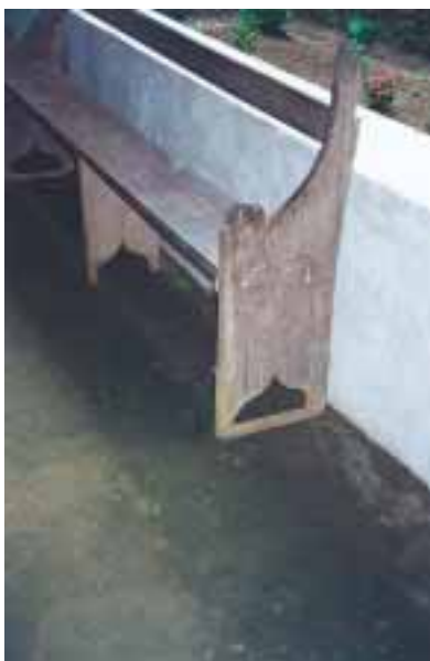
Piso em terra pátio coberto, Ig. Sta. Rita, Parati - RJ
