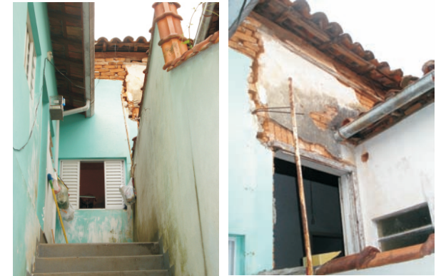
FOTOS 08 e 09 - Atual condição das residências
