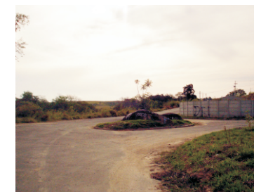
FOTO 05 - Trecho onde a pavimentação não está concluído
