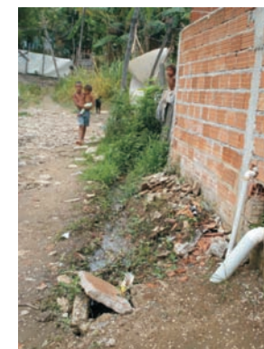
FOTO 19 - Esgoto a céu aberto
