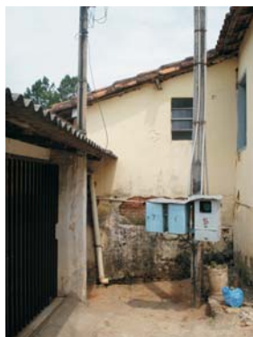
FOTO 02 - Detalhe das caixas de energia. Habitações aglomeradas.
