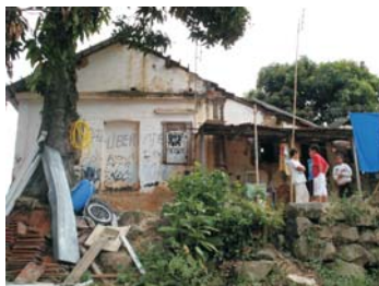
FOTO 10 - Edifício em ruínas, utilizado por famílias.
