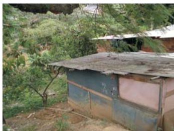
FOTO 12 - Barracos em péssimas condições
