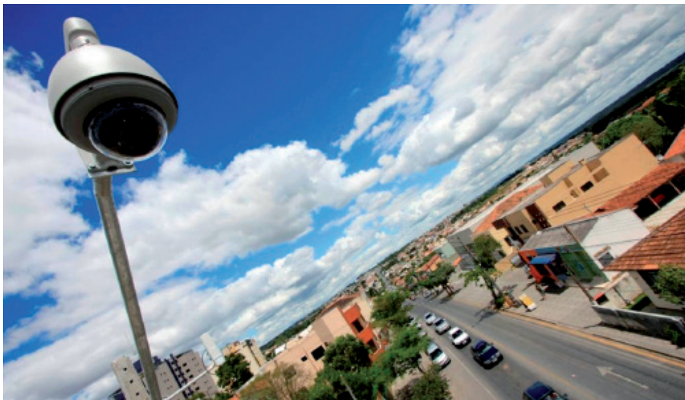
Sistema de câmeras de torre de monitoramento
