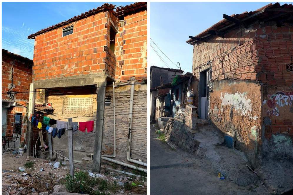
Figura 45 e Figura 46 - Habitações em situação de risco estrutural
