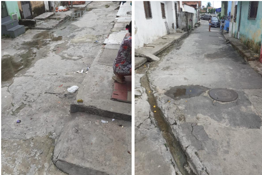
Figura 21 e Figura 22 - Situações de esgoto a céu aberto
