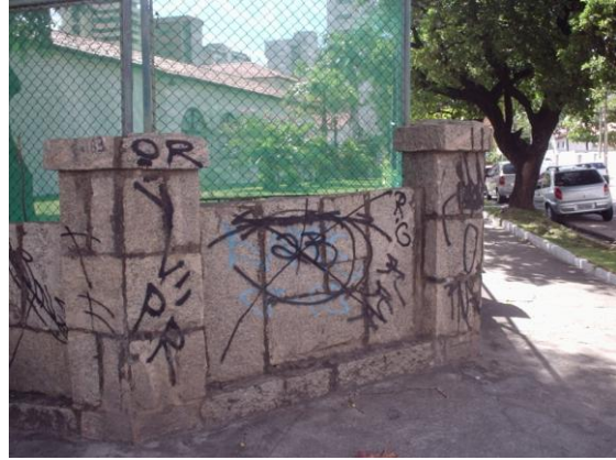
Muro de pedra circundante ao imóvel degradado por atos de vandalismo.
