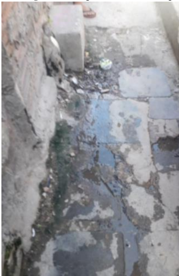
Figura 22 – Esgotamento exposto no interior da quadra 14
