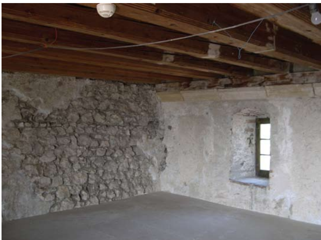
Fig. 3.21 – Recuperação dos interiores do Castelo de Aarburg Festung com diversas tipologias de argamassas de acabamento à base de cal e tintas. Suíça.
