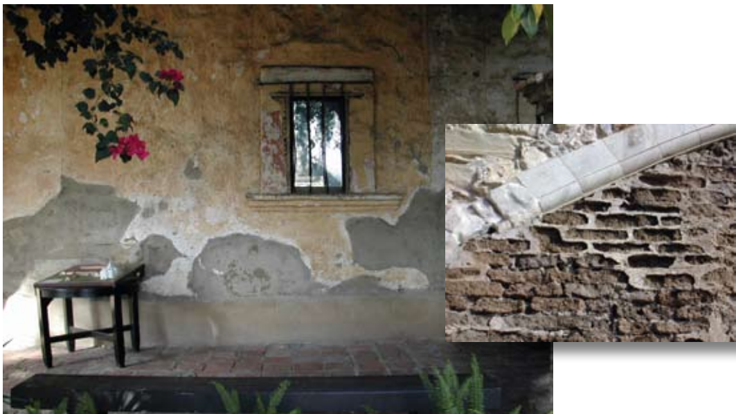
Fig. 1.19 – Intervenções com argamassas impermeáveis: degradação do reboco de cal acima e dos adobes. São Capistrano, EUA.
