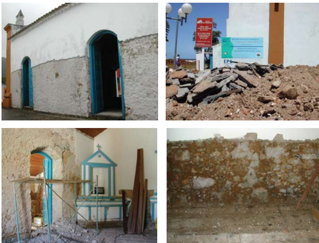
Fig. 1.20 – Intervenções com cimento, problemas de umidade e alteração estética, Ig. S. Sebastião, SC.
