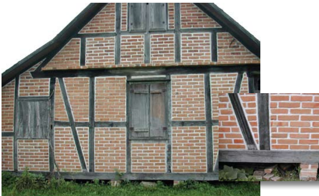
Fig. 1.16 – Intervenções de reparação dos rejuntas à base de cal em casas enxaimel, Pomerode, SC.
