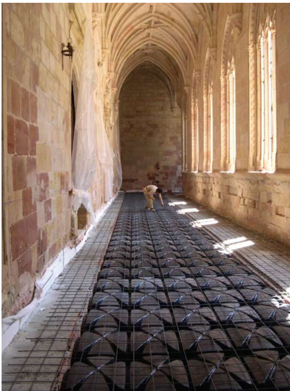
Fig. 1.25 – Câmaras de aeração para diminuir a umidade ascendente e os efeitos dos sais. Catedral de Sigüenza, Espanha.
