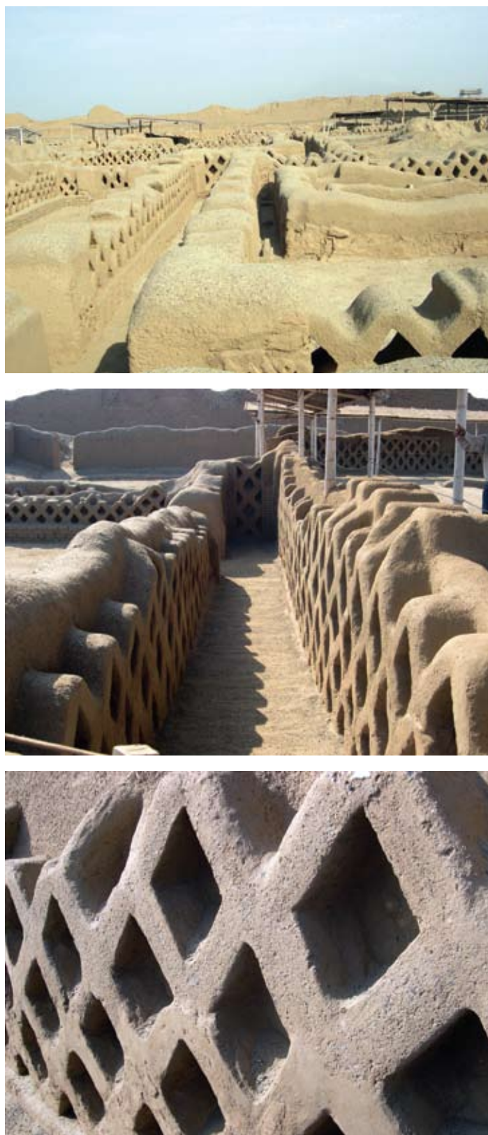
Fig. 3.18 – Capeamento das ruínas de Chan-Chan com argamassas de terra estabilizadas com cal. Peru.
