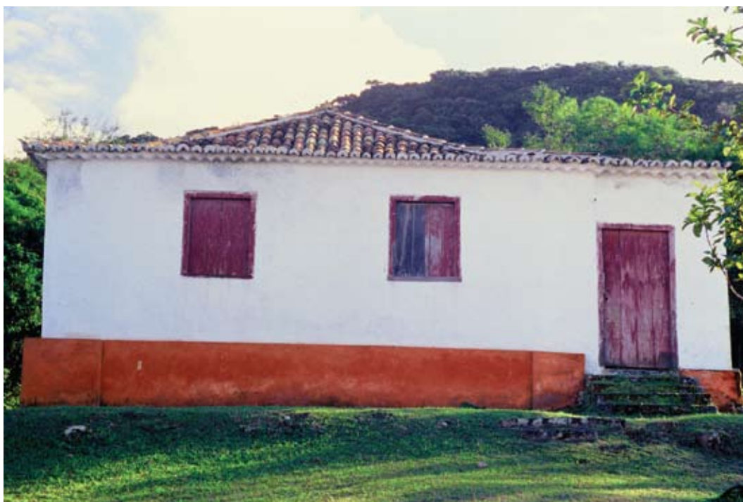
Fig. 4.5 – Recuperações com cal. Casa do Vigário, Lagoa da Conceição, Ilha de SC.
