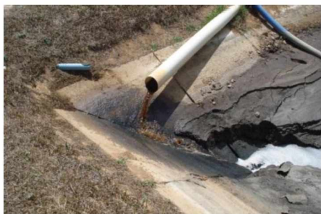
Lagoa anaeróbia – chegada do chorume/2011
