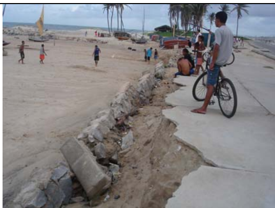
Fotografia 5 - Trecho da Avenida Costa Oeste em processo de degradação por ter sido instalado em área de domínio das marés e em uma faixa de praia submetida a processo erosivo acelerado (Fonte: Projeto Orla, fevereiro de 2006).
